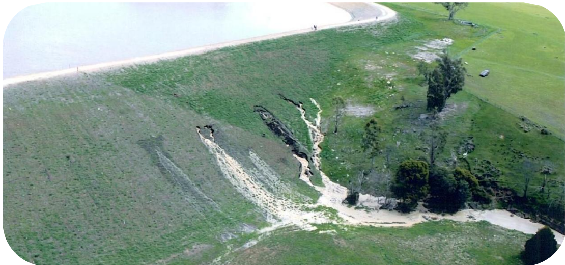
Erosão Interna e Piping no Talude de Jusante de Barragem. Tasmania, Australia .
