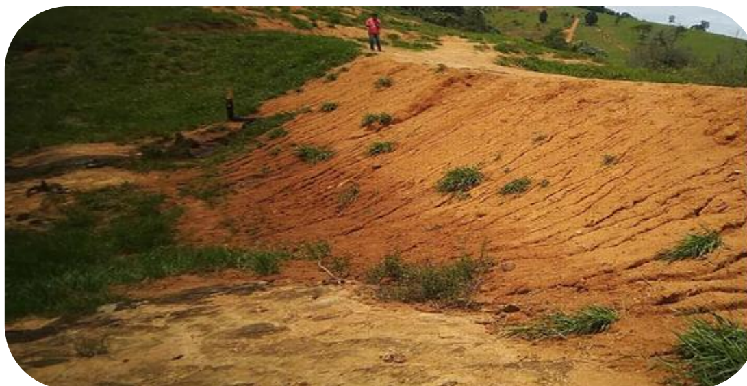
Umidade Anômala no Talude a Jusante.
