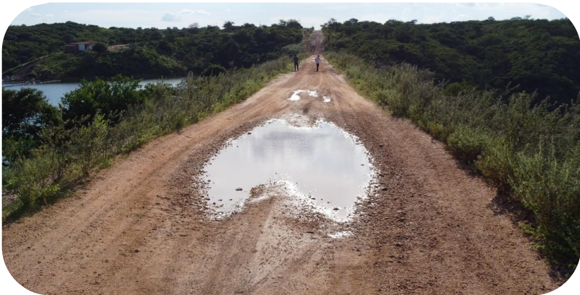
Afundamento e Poças de Água Pluvial na Crista.
