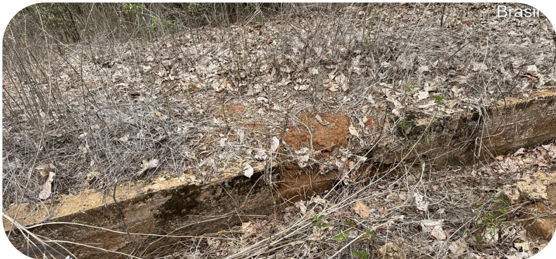
Deterioração dos Elementos de Drenagem Superficial.
