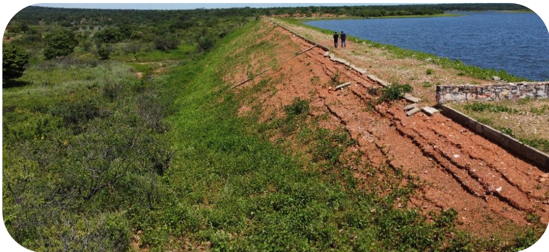
Erosão Superficial de Talude de Jusante da Barragem.
