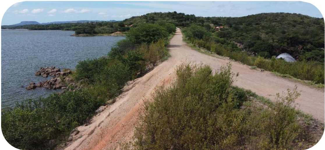
Vegetação Excessiva nos Taludes de Montante e Jusante.
