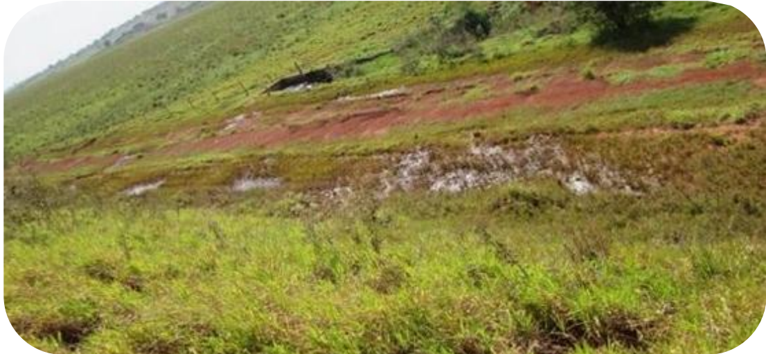
Surgência em Talude a Jusante da Barragem. Fonte da Imagem: IMASUL, 2016.
