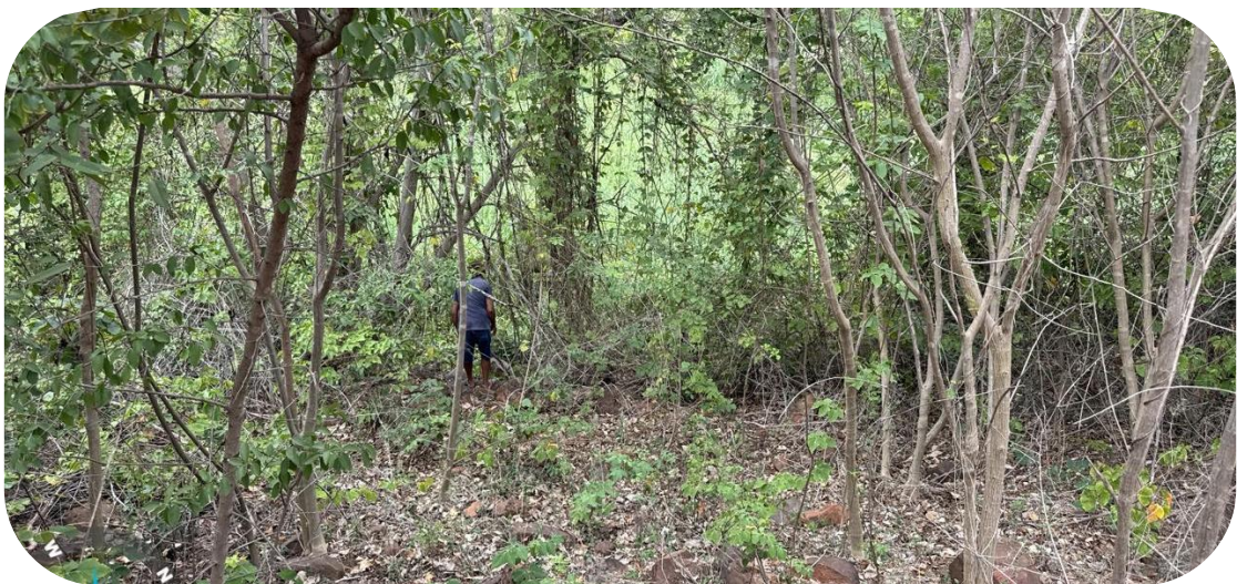
Vegetação Arbórea no Talude de Jusante da Barragem.
