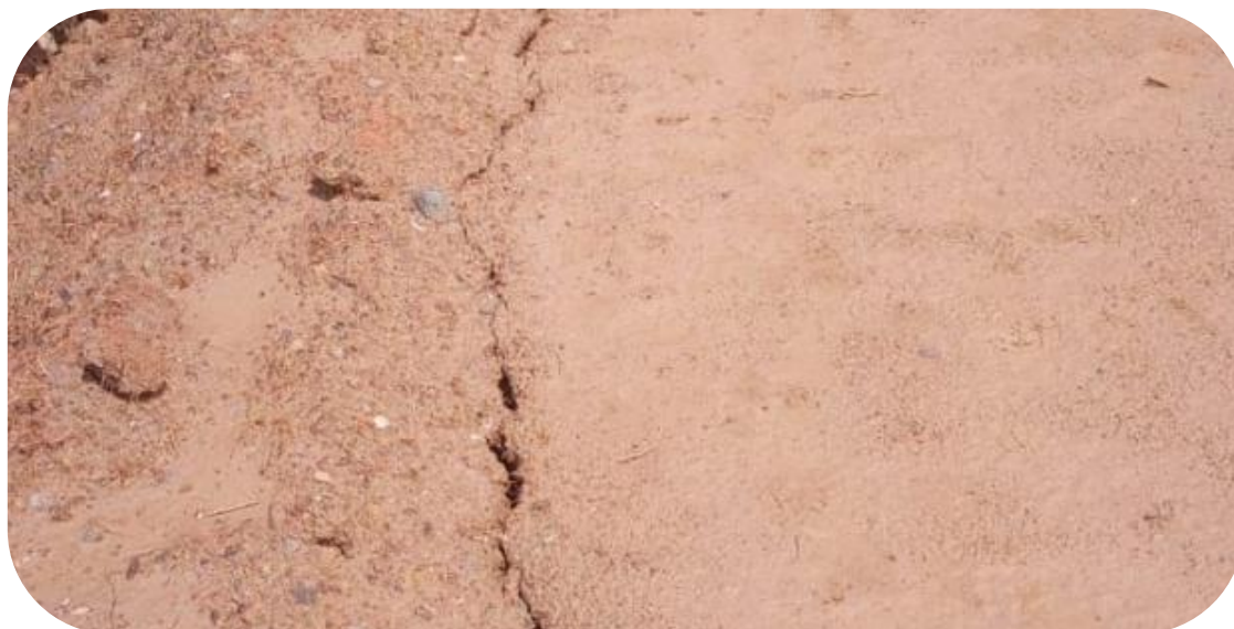
Trinca em crista de Barragem.
