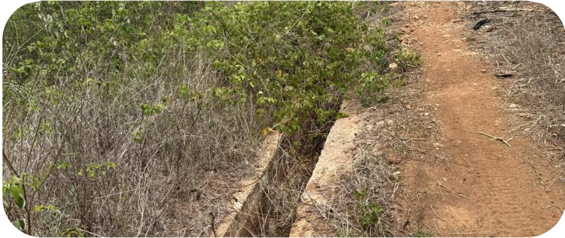
Obstrução dos Elementos de Drenagem Superficial.
