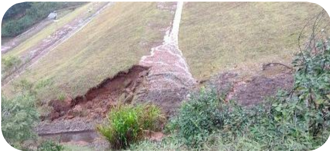
Escorregamento e Instabilidade de Talude.
