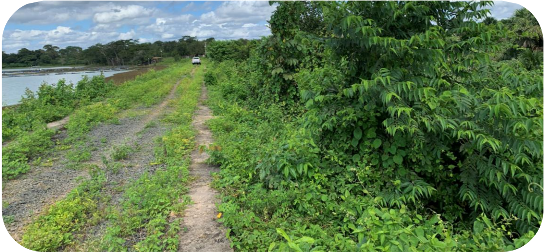
Vegetação Excessiva Crista da Barragem.
